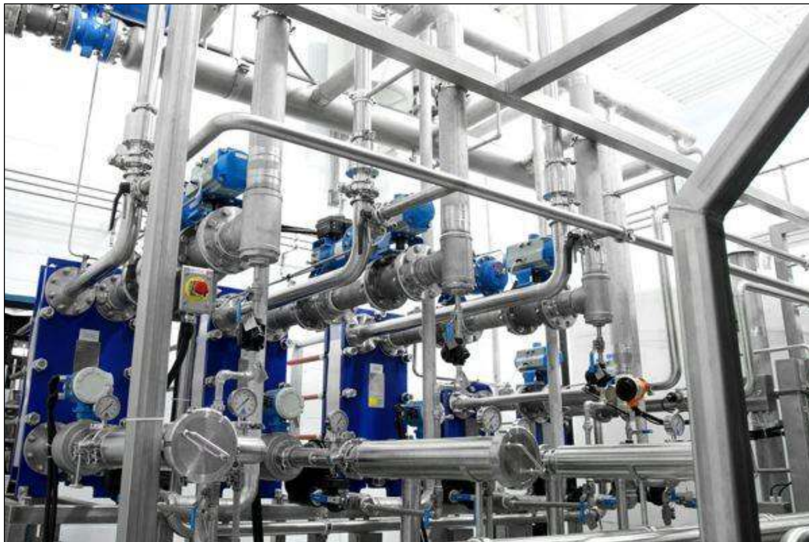
Sistema de tubulação em aço inoxidável
